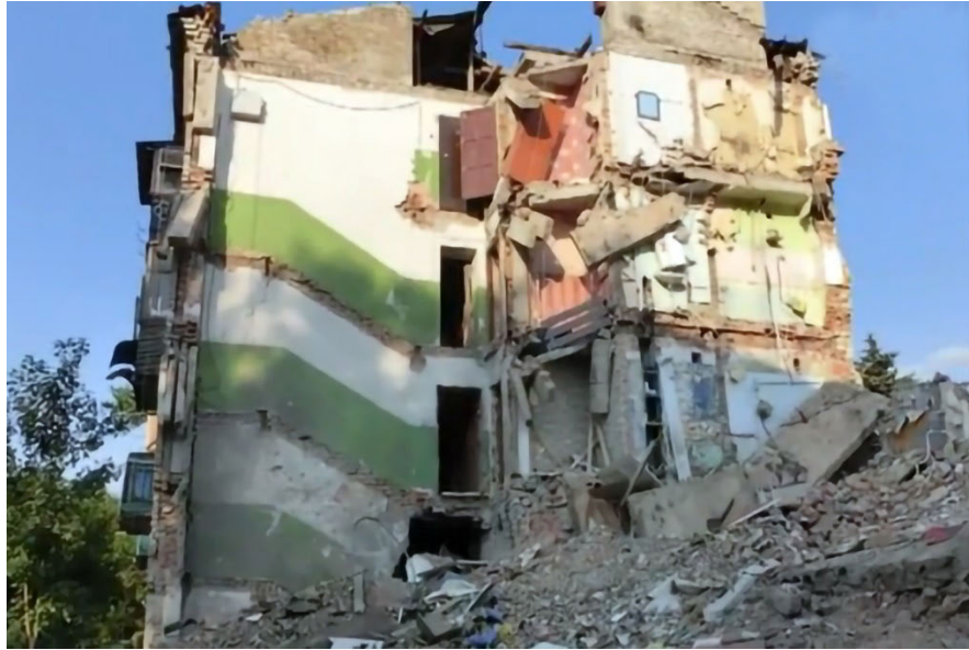
Beschädigtes Gebäude in Snizhne, Oblast Donezk, 6. August 2014; Bild Иван Сусанин, CC BY 3.0, via Wikimedia Commons
